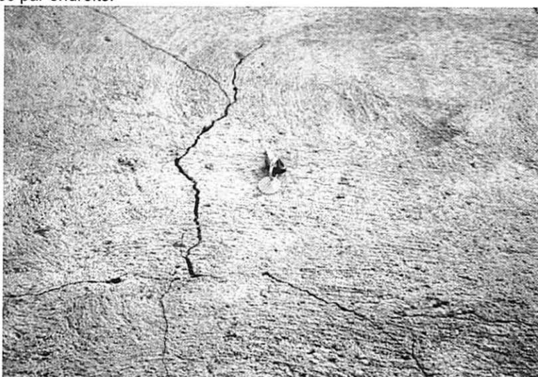
Figure IV.13 : Détail du réseau de fissures en surface de la pile n° 2 du pont « E ».
