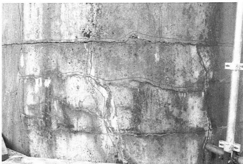
Figure IV.3 : Fissuration multidirectionnelle localisée aux extrémités du chevêtre de la pile 2 du pont « A ».
