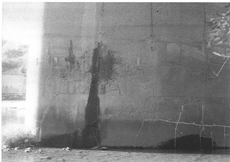
Figure IV.5 : Pile 2 du pont « B » présentant une fissuration en réseau.
