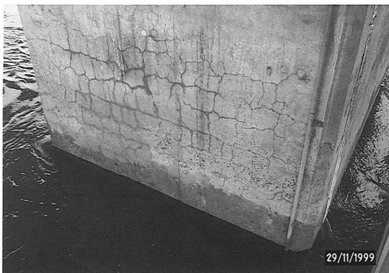
Figure IV.11 : Pile 6 du pont « D » présentant une fissuration en réseau dans la zone de marnage.
