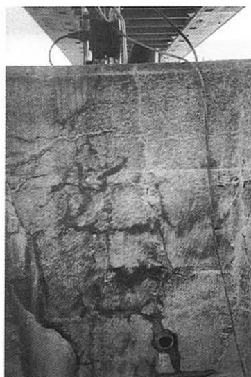
Figure IV.12 : Maillage de fissures sur la face latérale de la pile n° 2 du pont « E ».
